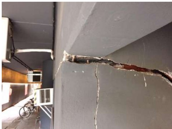
Figura 4. Patologia no prédio vizinho ao edifício público
