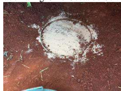
Figura 3: Ruptura por puncionamento
