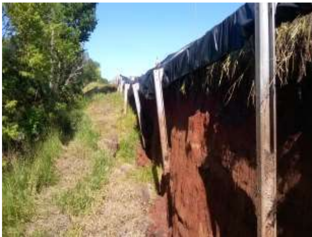
Figura 7. Ruptura do talude do km 76 da BR-290/RS
