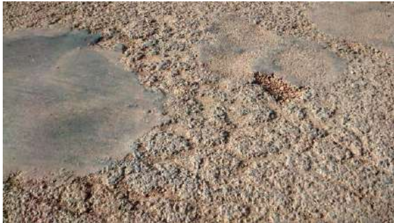
Figura 6 – Desgaste na Rua Pastor Albert Lembauer – Centro – Santa Rosa/RS
