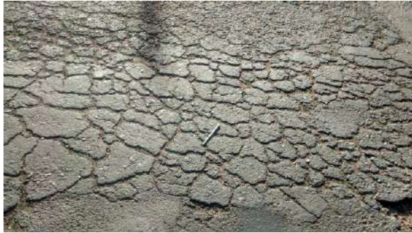
Figura 4 – Trincas tipo couro de jacaré na Rua General Rondon – Centro – Santa Rosa/RS
