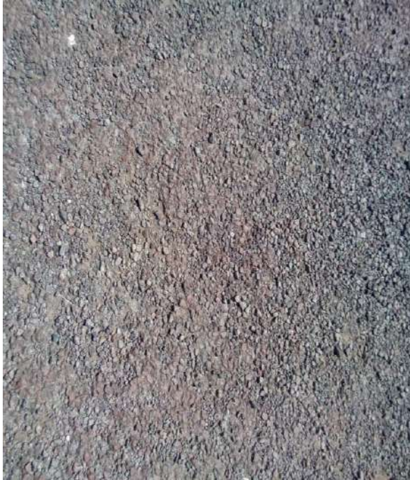
Figura 8 – Desagregação na Alameda General Osório – Centro – Santa Rosa/RS
