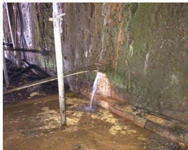
Figura 3. Fluxo de água pelo tirante no prédio público
