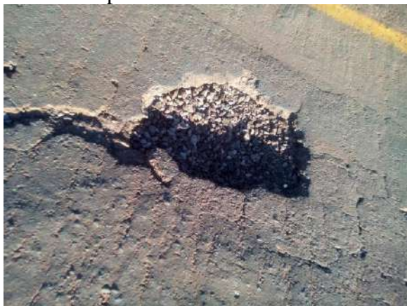
Figura 2 - Panela no trecho RS 305 entre Tuparendi e Tucunduva/RS
