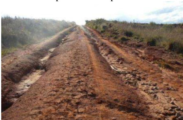
Figura 1 – Erosão no solo do CISM (MALLMANN, 2012).
